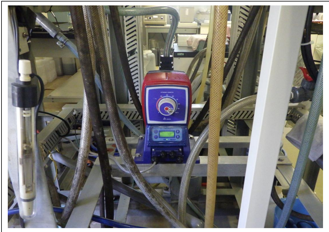
現場写真-2 魚類用原水導水ポンプ
