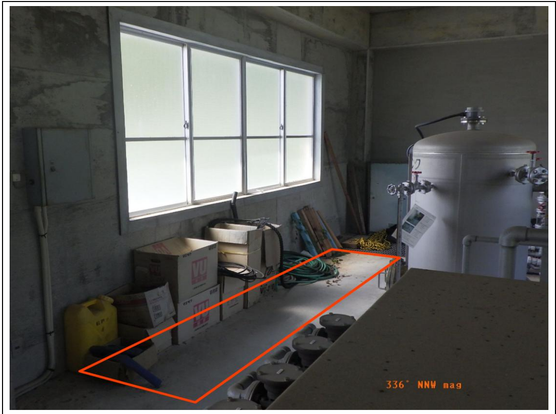
現場写真-4 急速ろ過池操作室内 (新設水質計器、魚類用原水導水ポンプ設置場所)
